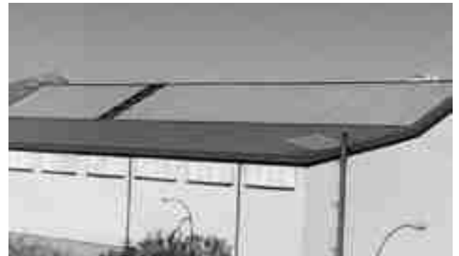
Algunas placas del techo del Polideportivo se desprendieron por el viento
