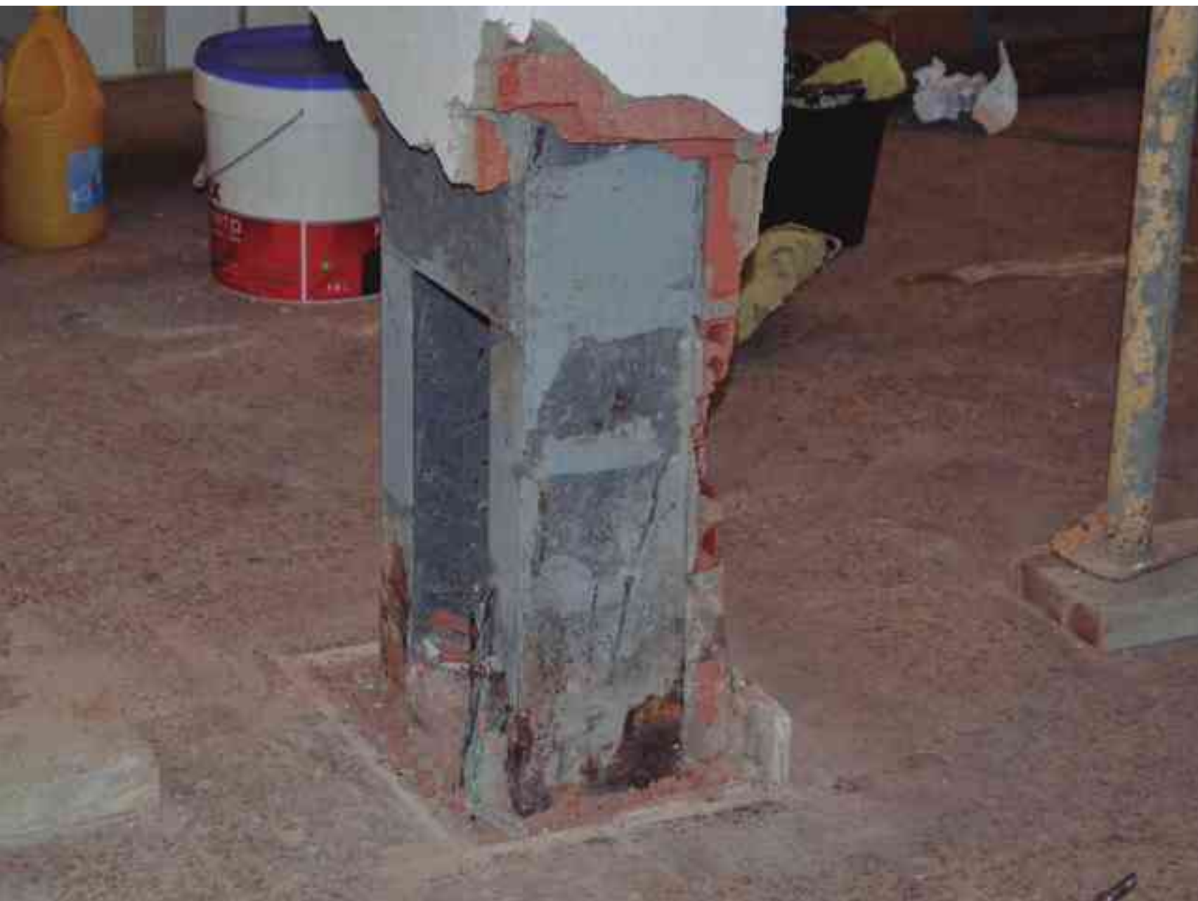
"Casa del Fester", sede de la Unión de Festejos, apuntalado desde hace unos meses
