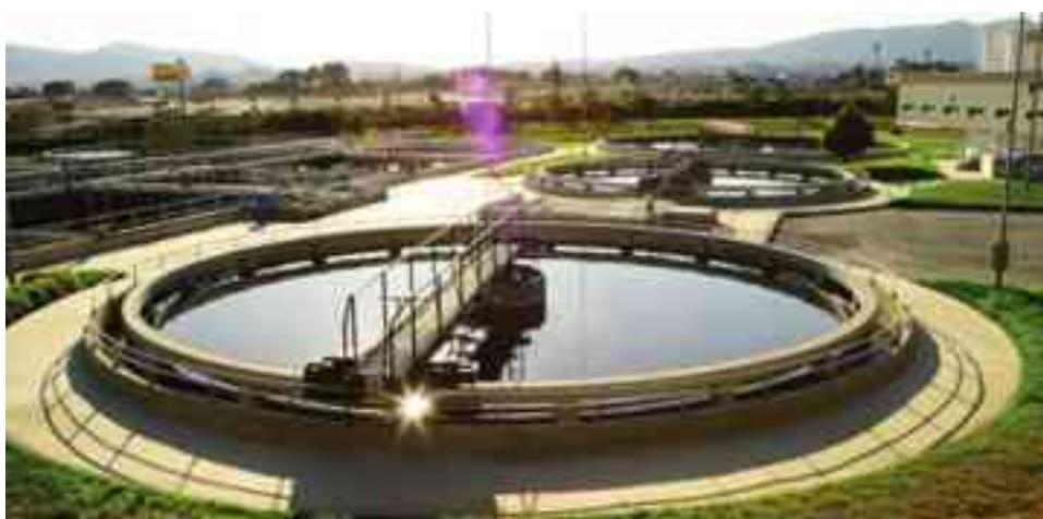
Depuradora de aguas residuales de la Mancomunidad
