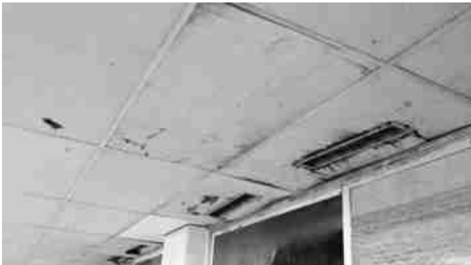
Estado que presenta el techo de las instalaciones de las Piscinas Cubiertas
