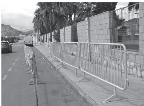
Estado actual de uno de los muros del polideportivo de San Fernando
