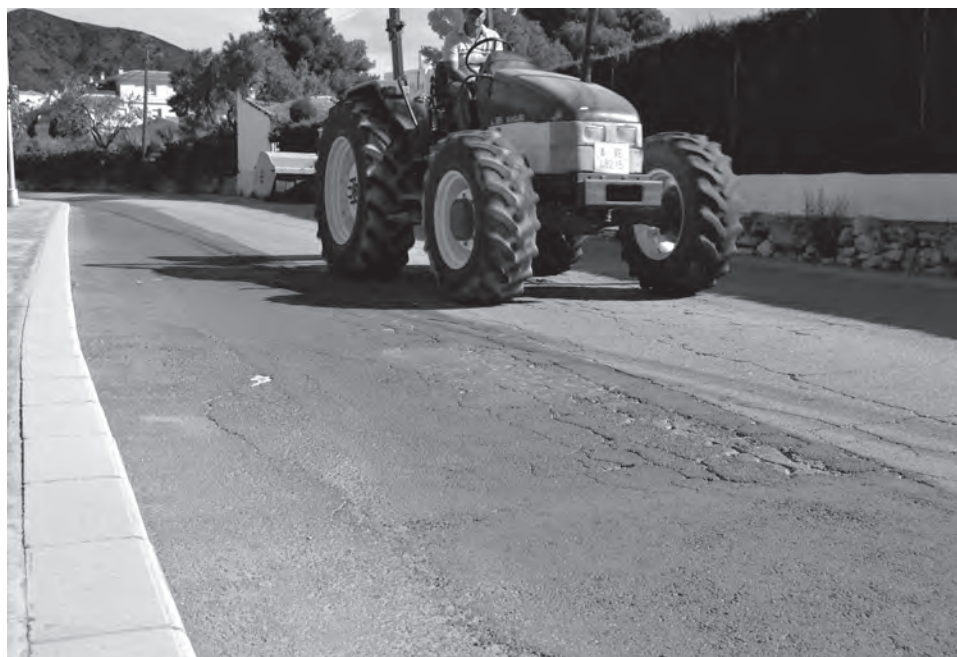
El mal estado del firme es evidente
