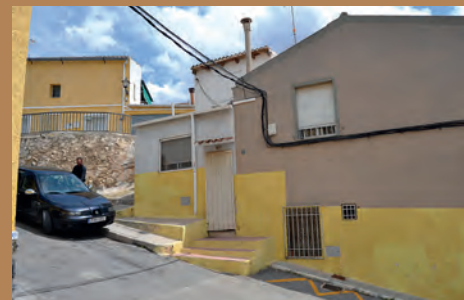
DESALOJADA UNA FAMILIA POR EL DERRUMBE DE UN TEJADO
