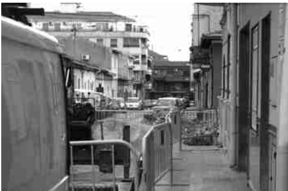
Imagen de archivo de otras actuaciones realizadas por Aguas de Alicante
