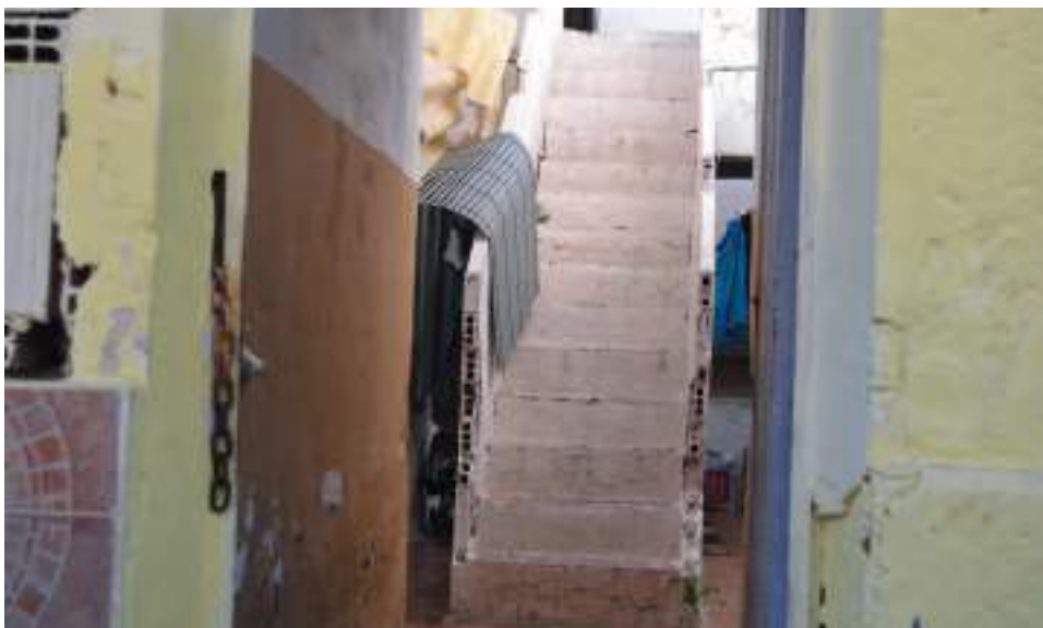
Escaleras en muy malas condiciones
