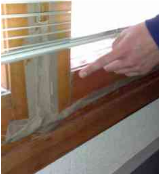
La carpintería del Ayuntamiento está muy mal y deja escapar el frío y el calor
