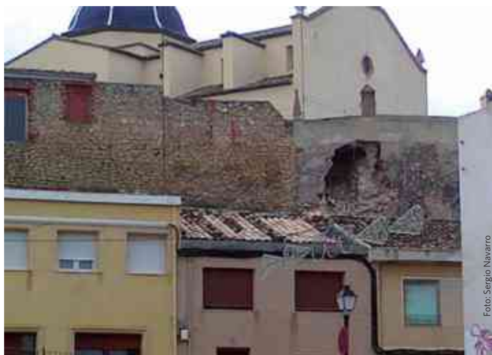
Imagen tomada desde el antiguo colegio Primo de Rivera de la zona afectada instantes después del desprendimiento
