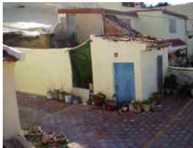
Una de las cuevas afectadas en la ladera norte del castillo
