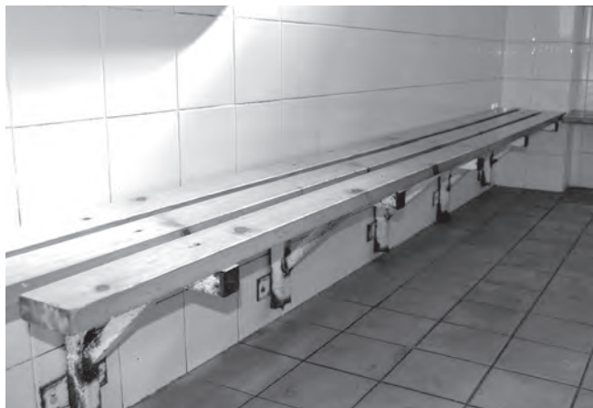
Algunos bancos de los vestuarios presentan muy mal estado
