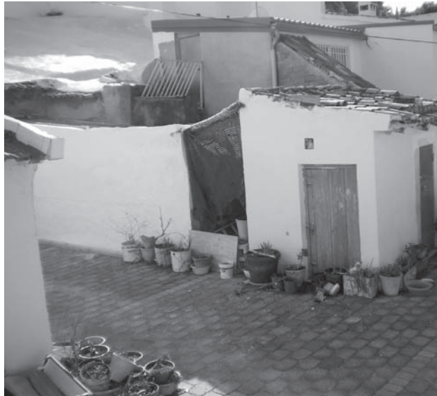
Casas cuevas afectadas por los derrumbamientos de ladera del castillo
