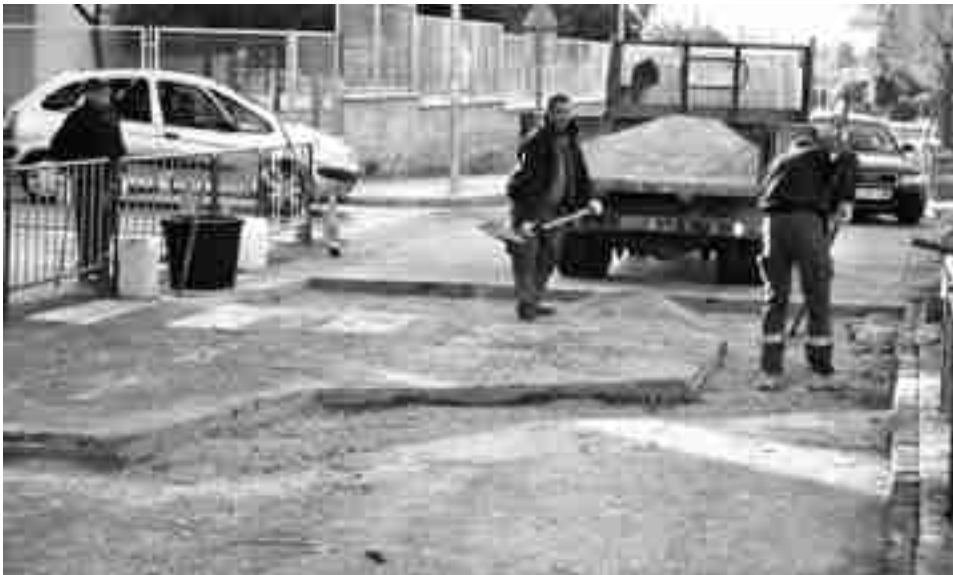
Tramo de la avenida Felipe V cotada al tráfico rodado, por obras, durante esta semana
