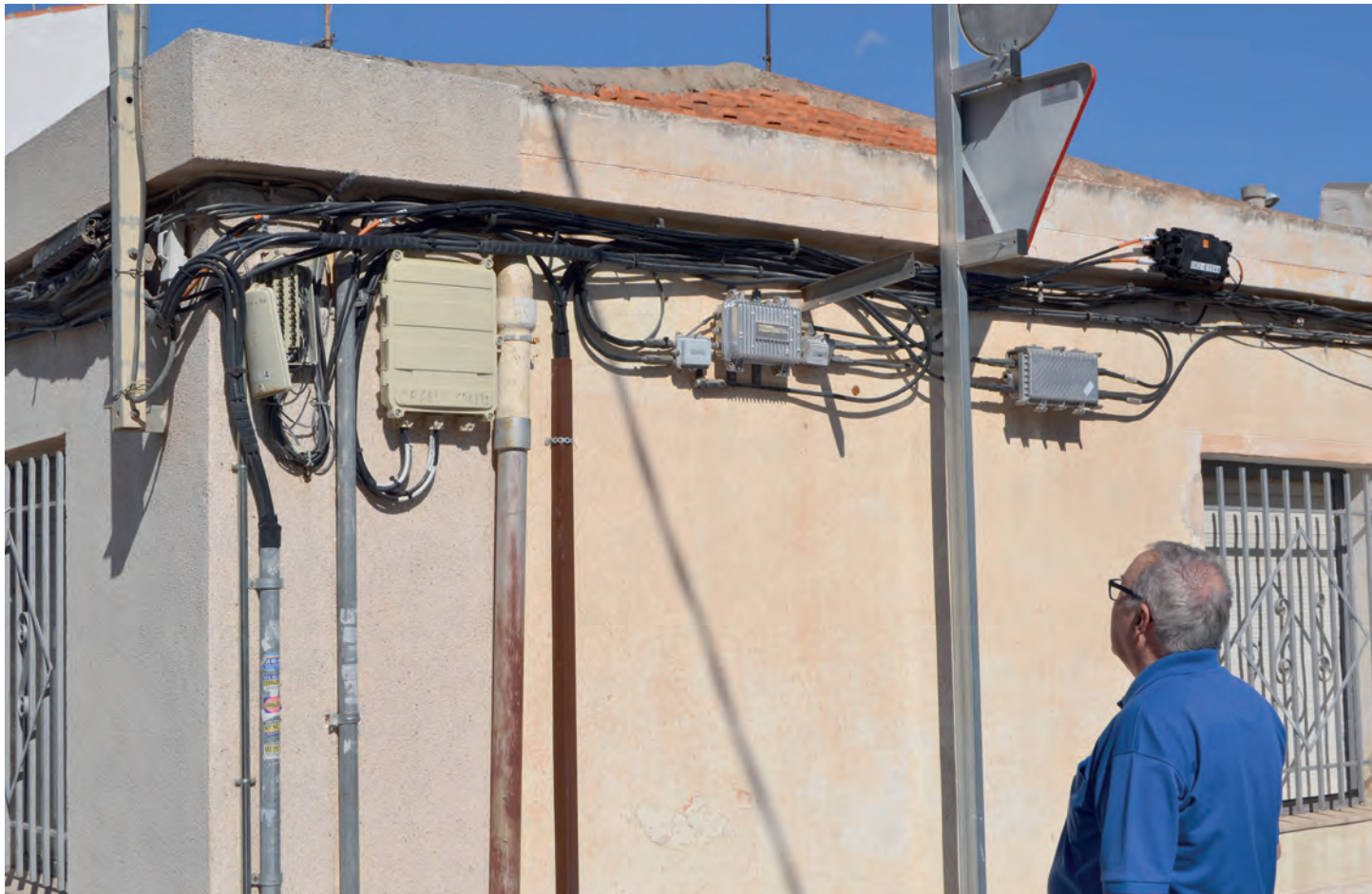
Un vecino de las viviendas de Salinetas observa el marasmo de cables que bordean la fachada de esta vivienda
