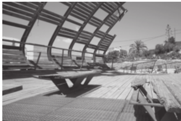
Zona de la Pasarela de San Rafael afectada por los actos vandálicos
