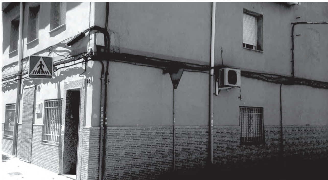
Fachada de una vivienda con exceso de cableado
