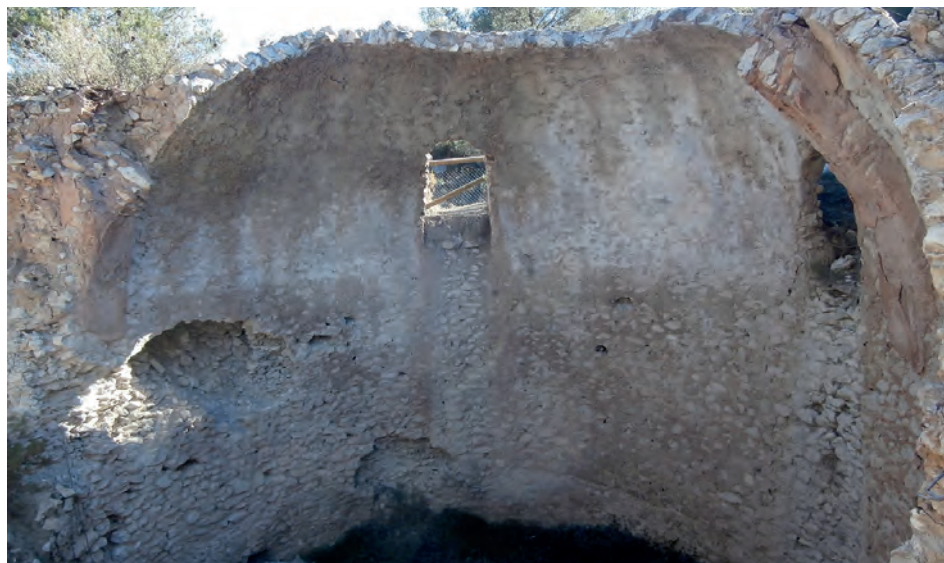
Estado actual del Pou de de neu Catí (fotografía enero 2015).
